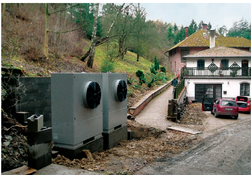
Při rekonstrukci topného systému penzionu byla použita tepelná čerpadla DIMPLEX LA 40 AS systému vzduch-voda
