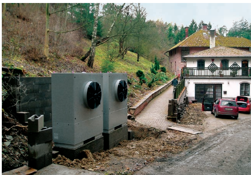
Při rekonstrukci topného systému penzionu byla použita tepelná čerpadla DIMPLEX LA 40 AS systému vzduch-voda
