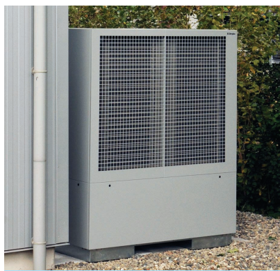
Venkovní instalace tepelného čerpadla LA-TU
